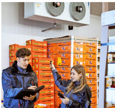
Arbeitet das Klimagerät im Obstlager richtig?
