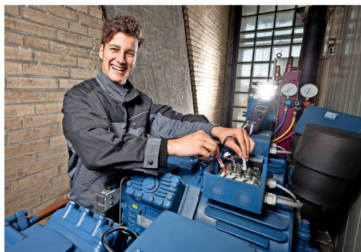
Jede Anlage muss genau eingestellt werden.
